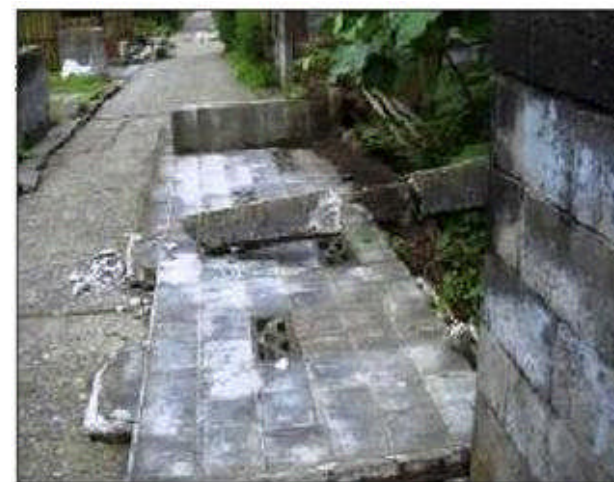
ブロック塀の倒壊
