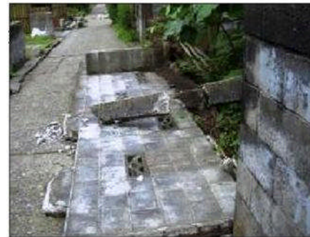
ブロック塀の倒壊
