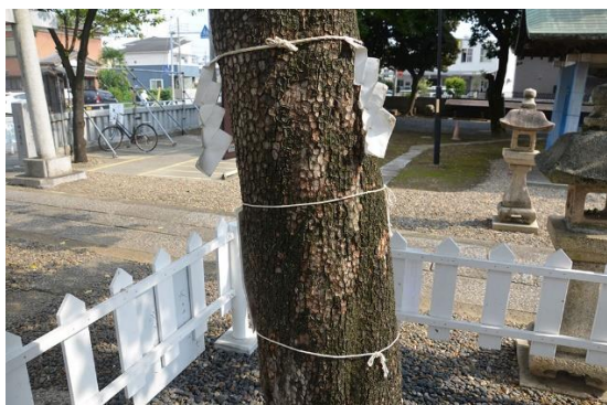
写真2 夫婦柿近景（白い箇所が剥がれている箇所）
