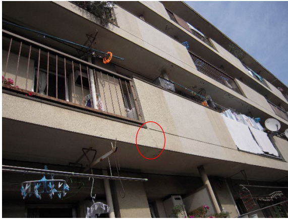
外壁クラック
