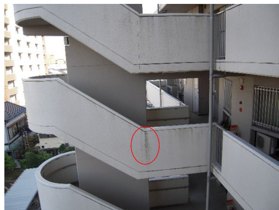
住棟北側階段外壁のクラック
