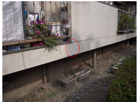
外壁クラック
