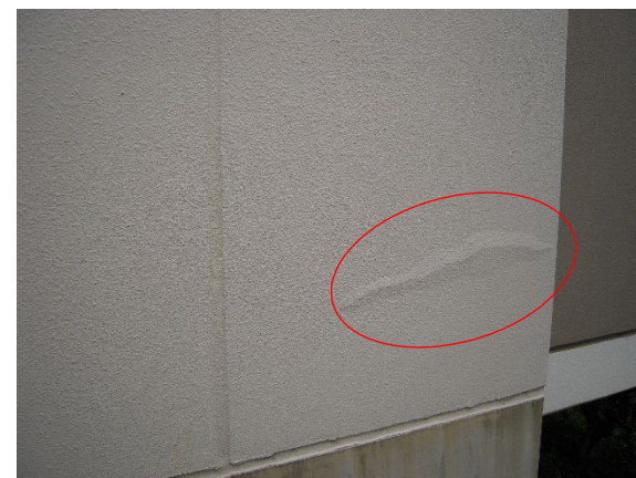
住棟西側外壁の浮き
