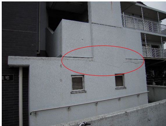
外壁のクラック
