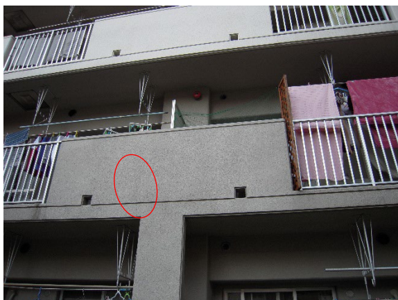
住棟南側の2階バルコニーのクラック
