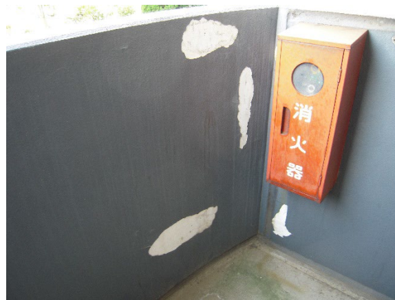
階段室の塗装剥離
