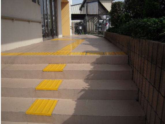
デイサービスセンター入口階段のクラック
