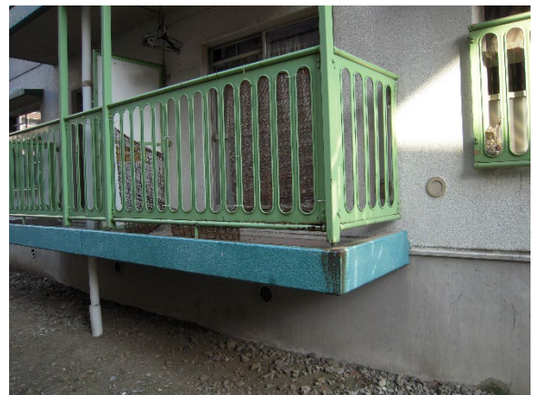
バルコニー手摺りの錆
