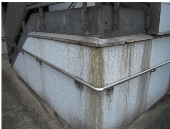
スロープ外壁の黒ずみ
