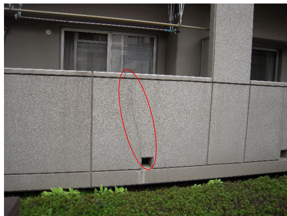
住棟南側バルコニーのクラック
