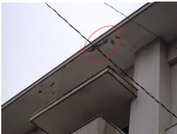
軒下塗装の剥離
