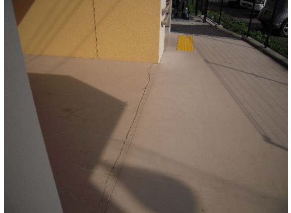
デイサービスセンター入口付近床のクラック
