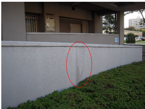
入口スロープ外壁のクラック
