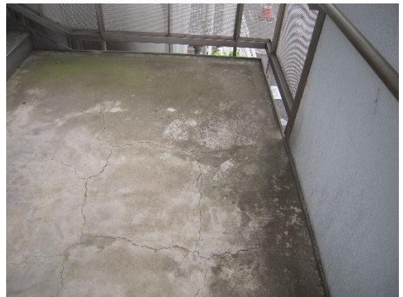
階段踊場床のクラック
