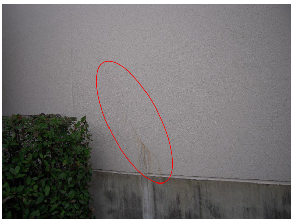
住棟西側外壁のクラック
