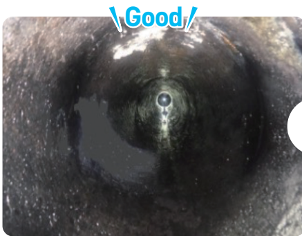
正常に流れている下水道管
