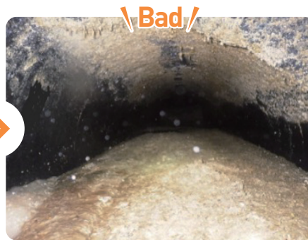
油の堆積によりつまった下水道管
