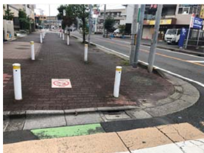
△歩車道境界の段差が大きい 誘導用ブロックがなく車止め に衝突する恐れがある
