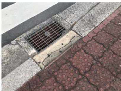
△側溝蓋の穴が動線上にある 誘導用ブロックが舗装と同色 でわかりにくい
