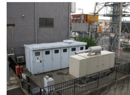
【地上階にある非常用電源設備】
