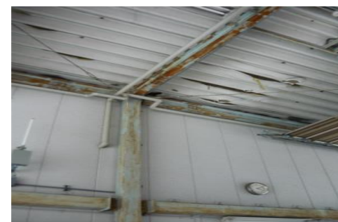
【老朽化した施設】
