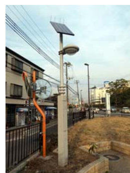
ソーラーパネルを装備した照明を広場に設置しています。
