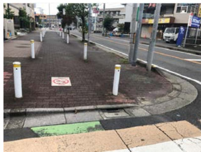
△歩車道境界の段差が大きい誘導用ブロックがなく車止めに衝突するおそれがある
