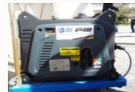
屋内運動場発電機
