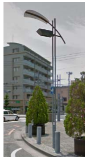
写真、道路照明灯
