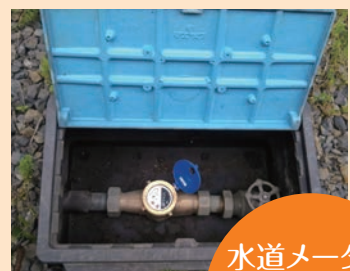
水道メーター
