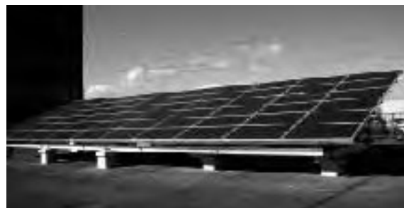
市役所屋上の太陽光発電
