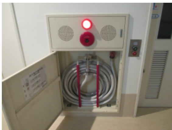
消火用散水栓
