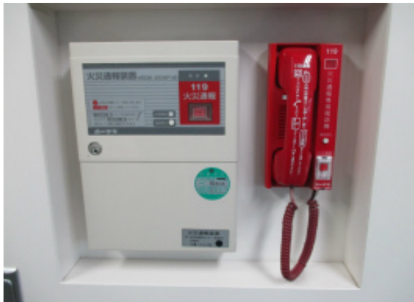
消防機関へ通報する火災報知器（本体）
