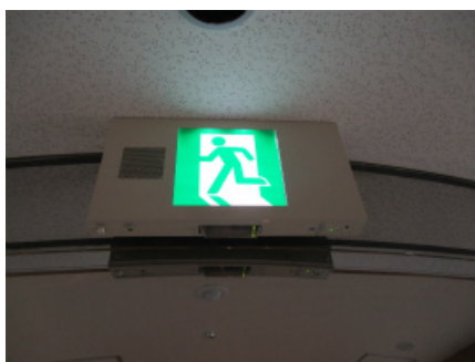
避難口誘導灯
