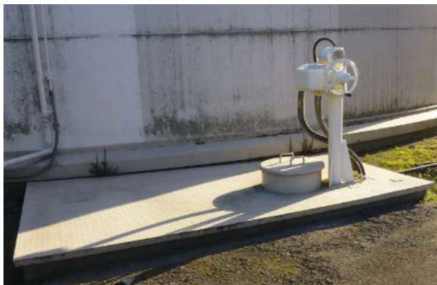
写真:西部浄水場の緊急遮断弁
