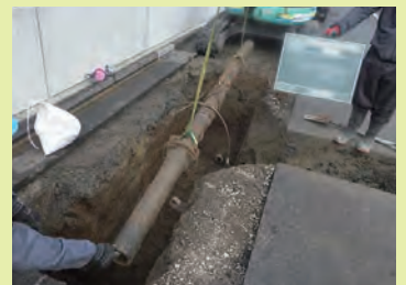
古くなった配水管
